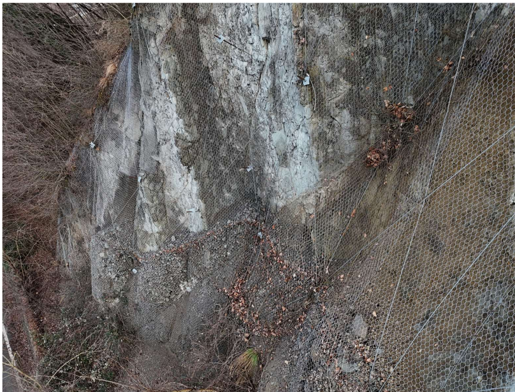
Figura 2: particolare delle reti svuotate con chiodi denudati e sacche di materiale alla base.
